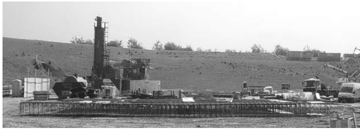
使用光纖光柵感測器監測連續壁變形情形
